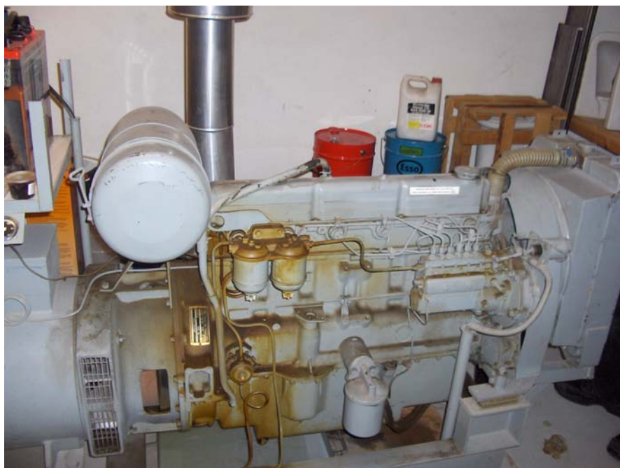
Konserthusets reservkraftsdiesel, anno 1972, ca 75 kVA
