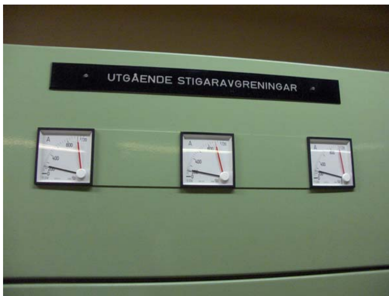
Bild, visande belastningen, dels vid låglast drygt 200 A och höglast drygt 650 A
